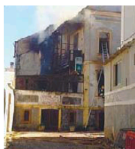
Edifício de construção antiga ficou inabitável
